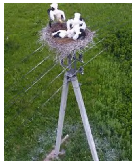
Рис. 7. Гнездо на опоре 10 кВт с изолированными проводами
